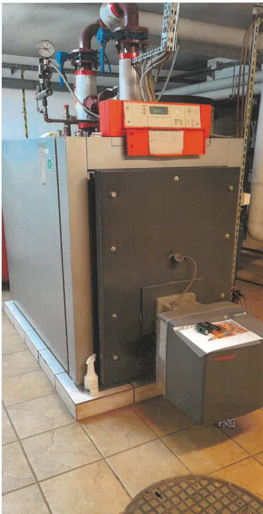
Fot. Nr 2 widok na istniejący kocioł olejowy i przewody przyłączeniowe obiegu grzewczego
