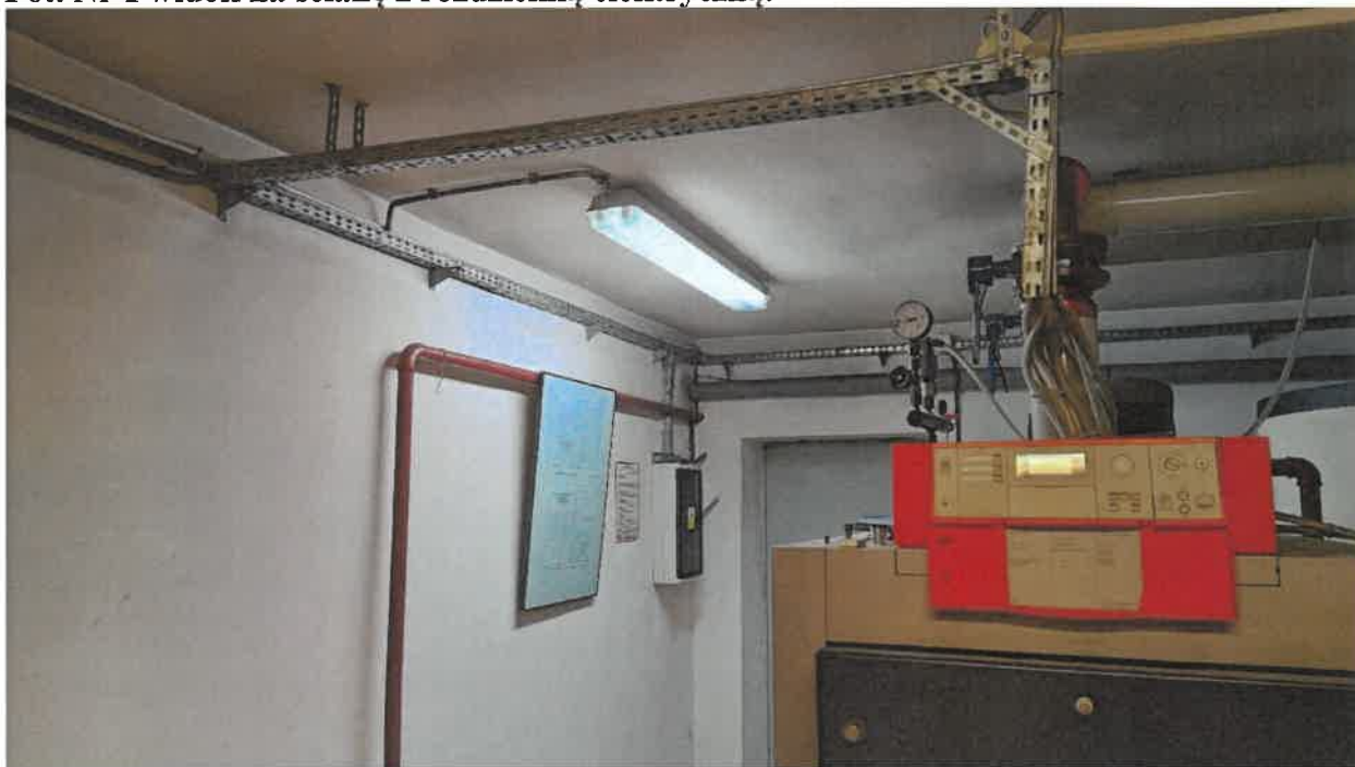
Fot. Nr 1 widok na ścianę z rozdzielnią elektryczną.
