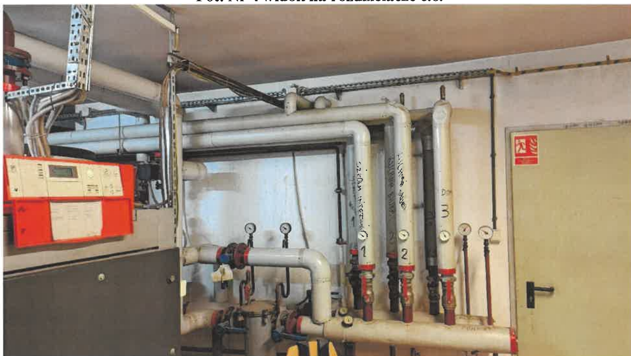
Fot. Nr 4 widok na rozdzielacze c.o.
